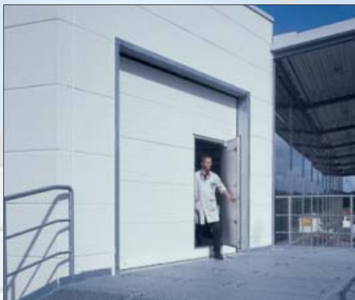
Секционные ворота SW с калиткой.
